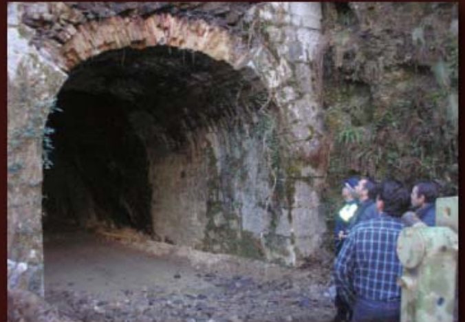
Observando los recientes desprendimientos en la boca Norte.
